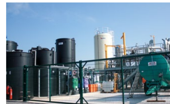
Centre de stockage de Téting-sur-Nied (57) : valorisation biogaz.
